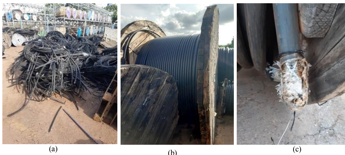
Figura 2: Aparas armazenadas: visão geral (a), detalhe de bobina (b) e detalhe de cabo danificado (c)
