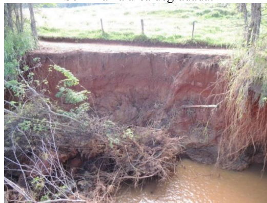
Figura 8b. Margem direita do Córrego Afluente do Rio Sozinha na área degradada.
